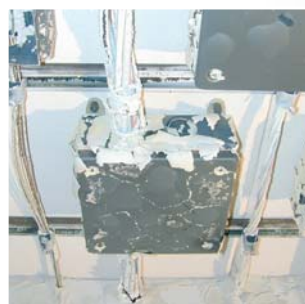
Ответвительная коробка с подключенными кабелями после проверки.
