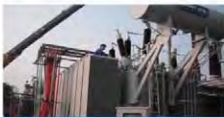
Бангладеш: силовой трансформатор для Aggreko
