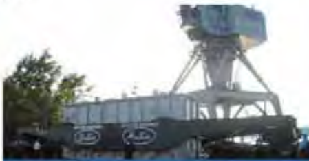
Сербия: трансформатор 400kV 400MVA
