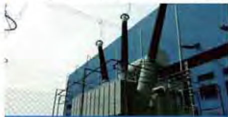
Индия: трансформатор 420kV 60MVA
