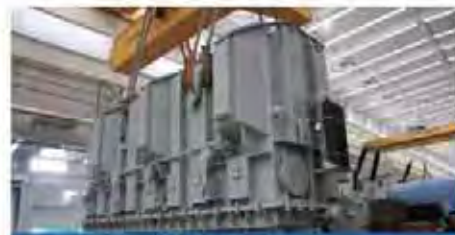
Пуэрто-Рико: трансформатор USA230kV 570MVA
