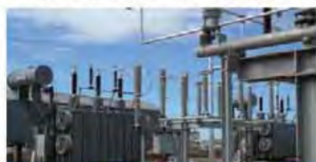
Австралия: трансформатор 132kV для ВНР
