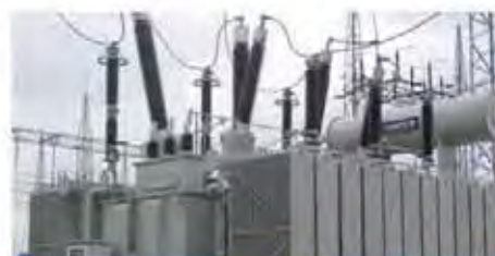
Эквадор: силовой трансформатор для CELEC S.A
