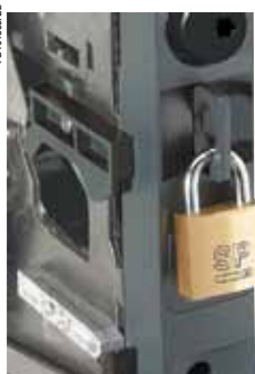
Блокировка в положении «выкачено» навесным замком
